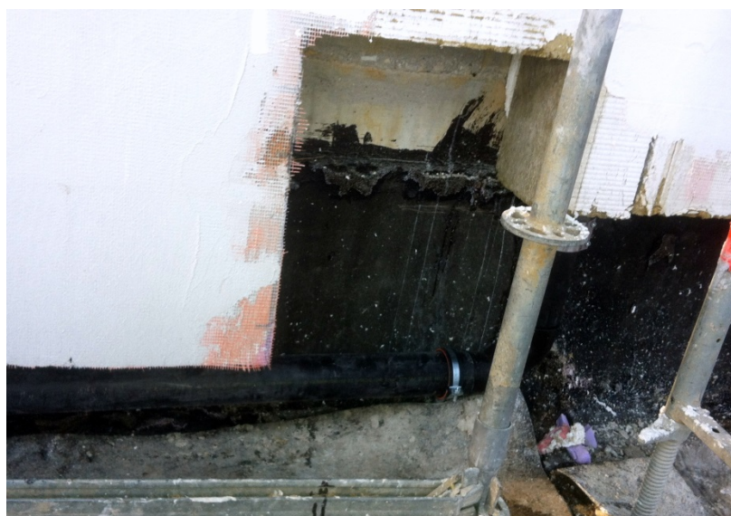
Abbildung 18: Fallstrang in der Dämmung
