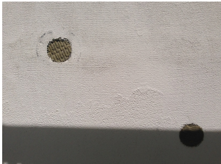
Abbildung 19: Nachträglich ergänzte Dübel
