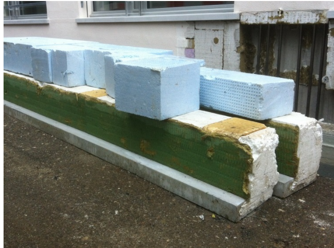
Abbildung 20: Anzunehmende vorgefertigte Elemente
