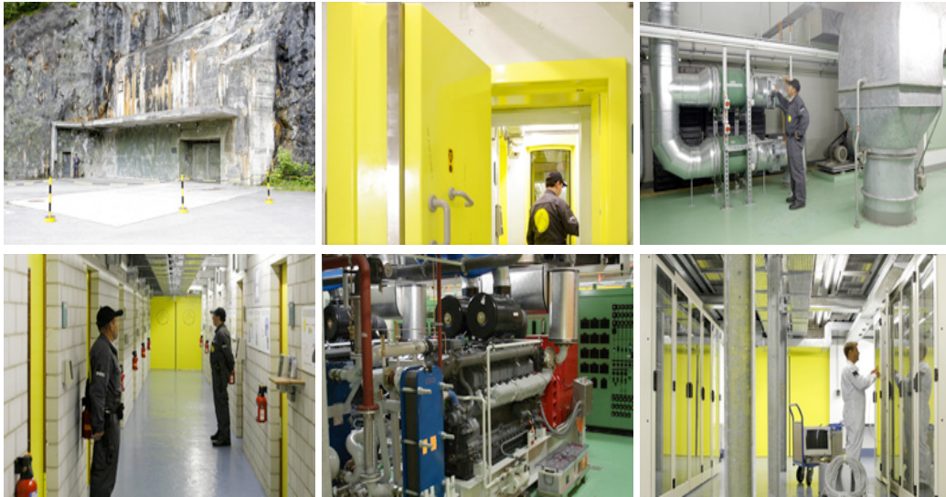
Abbildung 1: Impressionen aus dem hochsicheren Data Center "Swiss Fort Knox"
